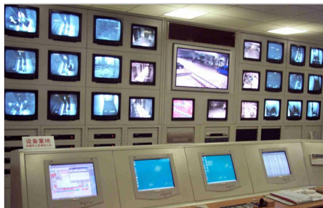
图 2-50 杭州歌德大酒店总控平台
